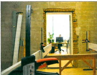
Arbeiten im Büro ohne Tür. Im Rathaus derzeit kein Witz. Auf dem Flur im ersten Obergeschoss werden derzeit die Innentüren erneuert.
